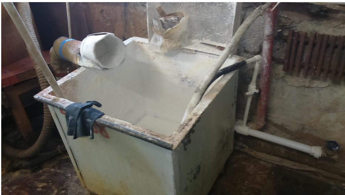
Рисунок 3.1. Действующие очистные сооружения гальванического производства 1
