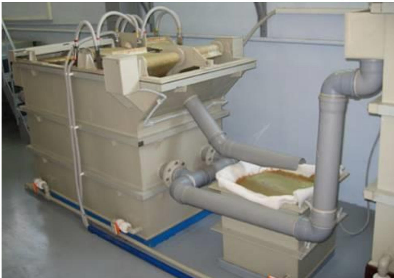
Рисунок 5.1. Электрофлотатор на очистных сооружениях металлообрабатывающего предприятия – общий вид
