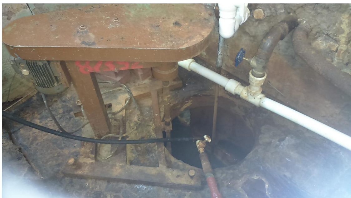
Рисунок 3.2. Действующие очистные сооружения гальванического производства 2
