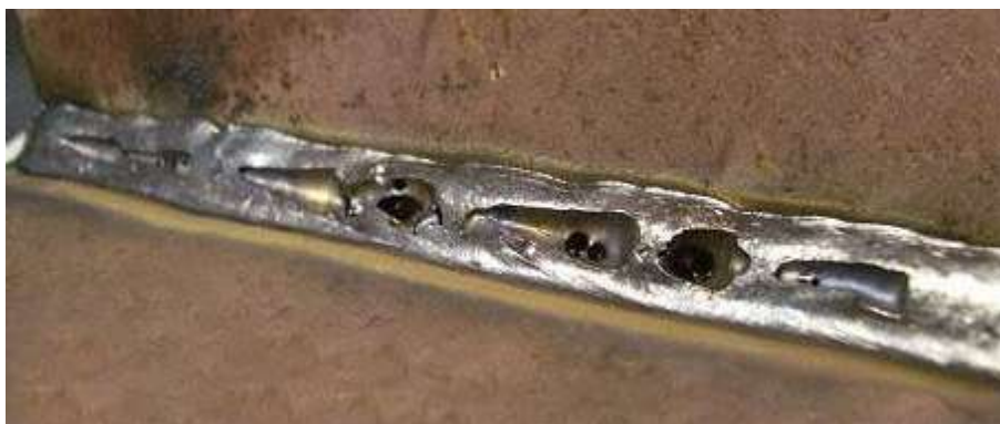
Рисунок 1.1 – Пример дефектов сварного шва
