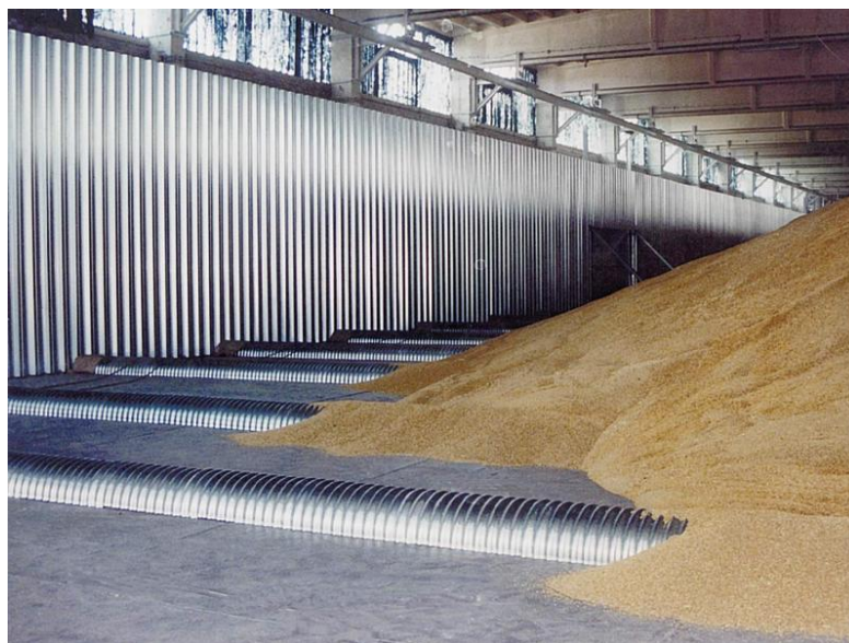
Рисунок 2.14 – Установка активного вентилирования зерна
