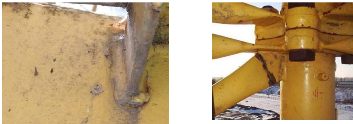
Рисунок 2 – Трещины основания крепления кабины башенного крана
