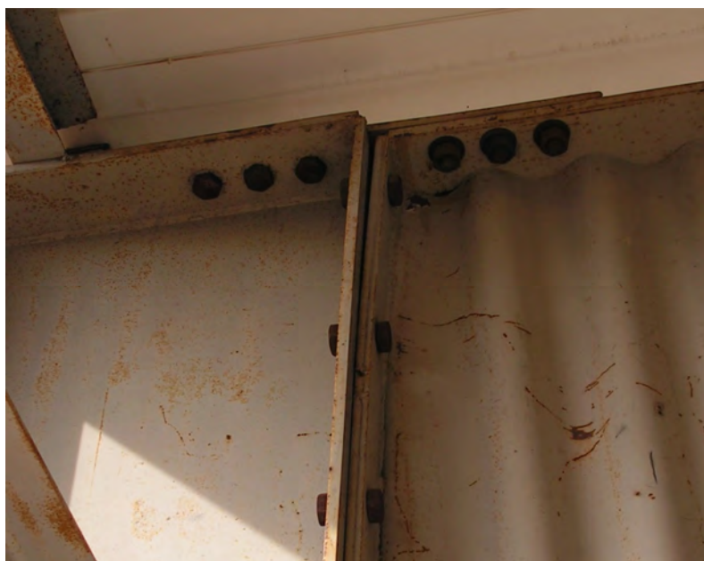
Рисунок 5 – стык балки покрытия с колонной, выполненный с зазором
