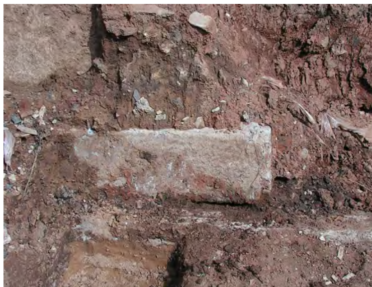
Рисунок 2 – Зазор, заполненный глиной и пр. , между подошвой фундамента и монолитной плитой
