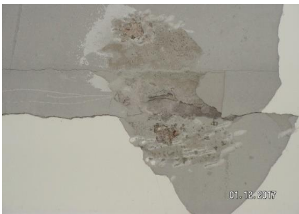
Рисунок 7 – Аудитория 1609 ОГУ. Трещины по шву между плитами покрытия проходят от простенка в осях 5-Д до пилона в осях 5-Г.
