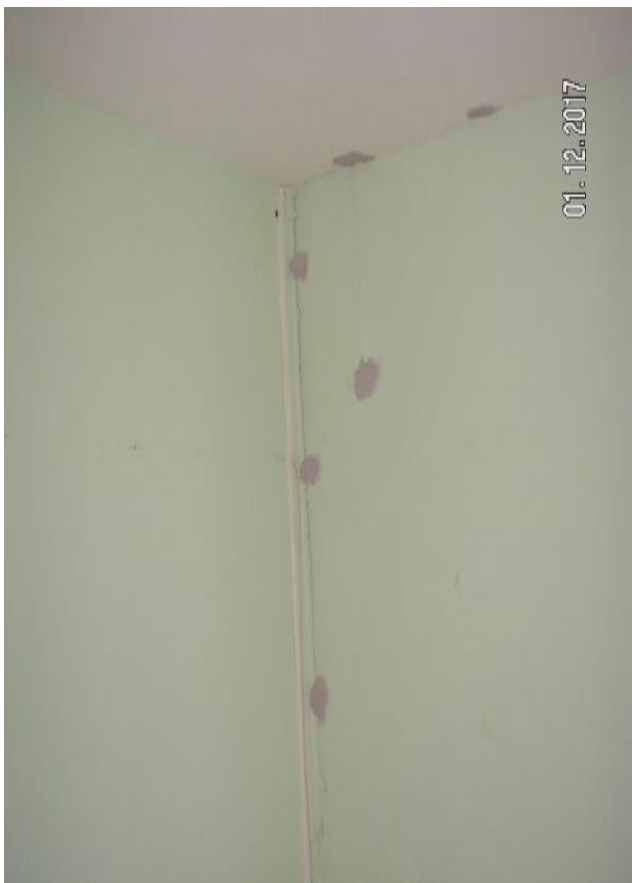
Рисунок 6 – Трещина в сопряжении кирпичных стен с кирпичной кладкой и плитой покрытия в аудитории 1609 ОГУ.
