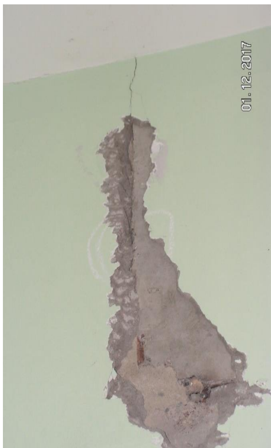
Рисунок 5.а – Трещина в пилоне в осях 5-Г аудитории 1609 ОГУ, проходящая от плиты покрытия по торцу балки покрытия.
