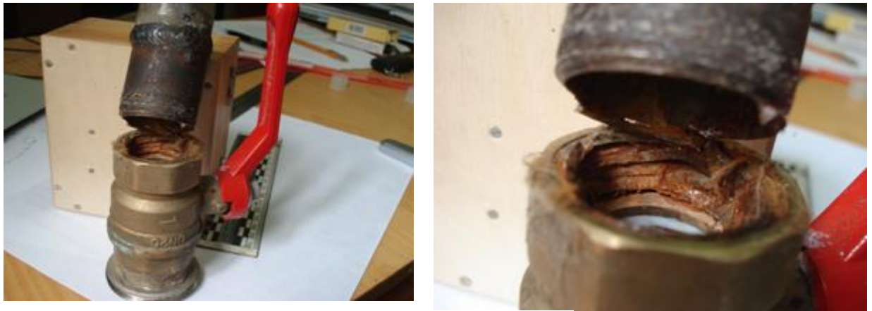
Рисунок 1 – Общий вид разрушенного соединения
